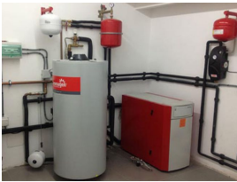
Produit Installation de chauffage central
