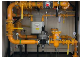
Ürün Doğalgaz İstasyonu
